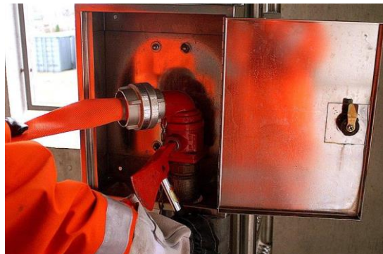
Abb. 9: Löschwasser-Entnahmeeinrichtung (Quelle: LFS Baden-Württemberg)
